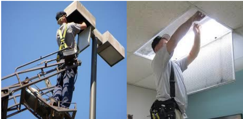
شکل (۳-۸) انجام نت منظم سیستم روشنایی در داخل و خارج ساختمان‌های شرکت
